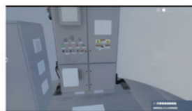
1 主畫面：於風機內部移動，與設備外部介面互動並遠程控制實體電箱。
